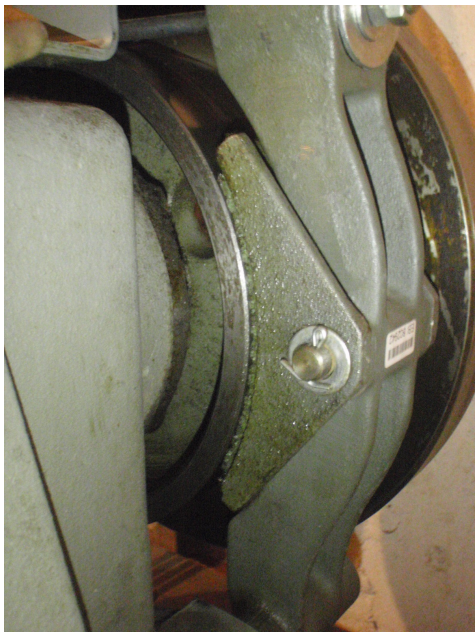
Asbestverdächtige Bremsbeläge eines Lifts
