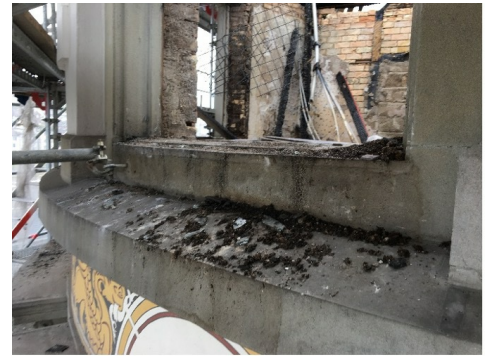
Asbestzement-Schindelreste auf Fassade, Markus Durrer, IBH Expertenstelle Chur
