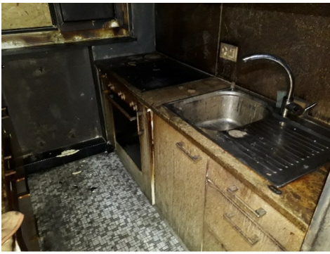
Stark verrusste Küche, Markus Durrer, IBH Expertenstelle Chur
