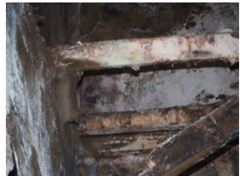
Durch Fäulnis und Pilze eingebrochene Decke, Markus Durrer, IBH Expertenstelle Chur
