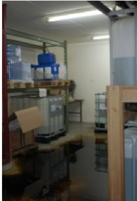
Ölverschmutztes Löschwasser im UG, Markus Durrer, IBH Expertenstelle Chur
