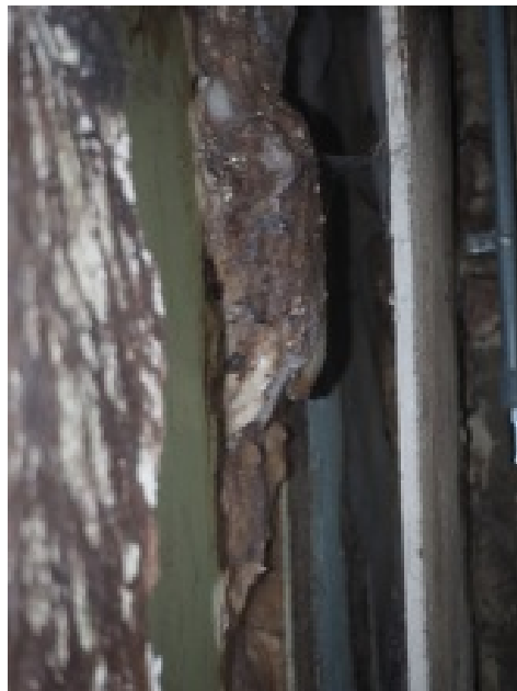
Durch Fäulnis und Pilze eingebrochene Decke, Markus Durrer, IBH Expertenstelle Chur
