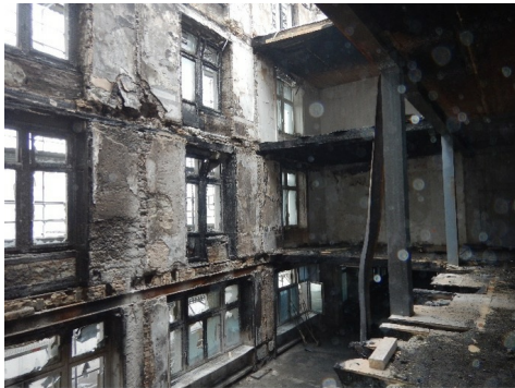
Grossbrand in Bürogebäude, Markus Durrer, IBH Expertenstelle Chur
