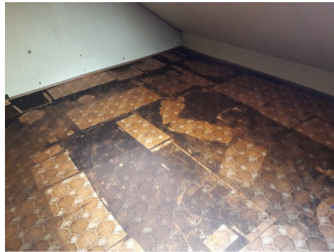
Verrusster Bodenbelag nach Aufräumarbeiten, Markus Durrer, IBH Expertenstelle Chur
