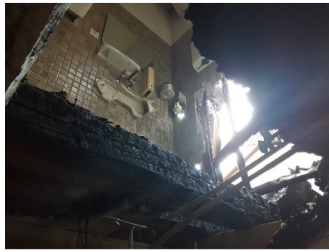
Fliesen, «nicht beprob- und sanierbar», Markus Durrer, IBH Expertenstelle Chur
