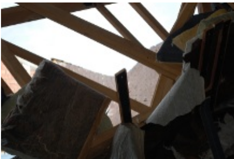
Unter Schneelast eingebrochenes Dach (Faserzement), Markus Durrer, IBH Expertenstelle Chur
