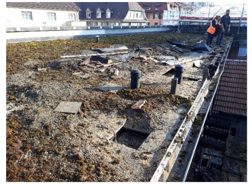
«Lüftungsöffnungen» im Dach der Feuerwehr, Markus Durrer, IBH Expertenstelle Chur
