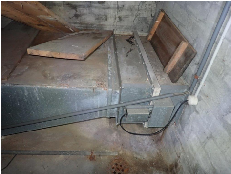
Leichtbauplatte zwischen Lüftungskanälen, ohne Quelle
