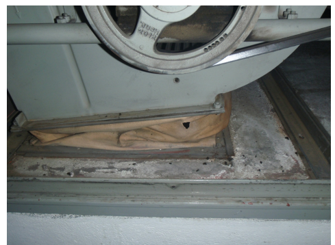
Asbesthaltiges Gewebe zwischen Lüftungsmotor und Sockel.
