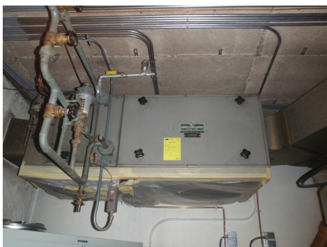
Monobloc der Marke "Svenska" mit Asbest im Gehäuse
