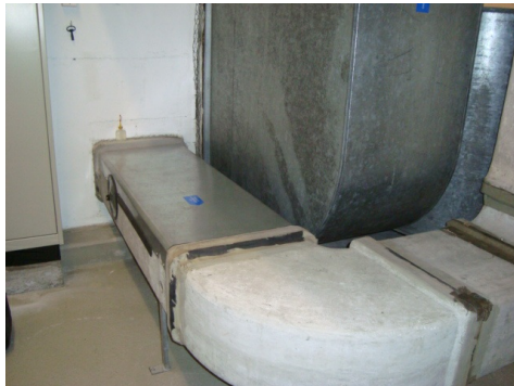
Lüftungskanal aus Asbestzement, Carbotech
