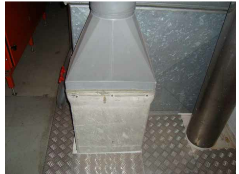
Lüftungskanal aus Asbestzement, übergehend in Kunststoffkanal, Carbotech
