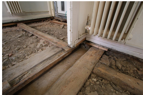
freigelegte Radium-kontaminierte Schlacke eines Zwischenbodens. Photo: G. Di Tommaso et al., BAG
