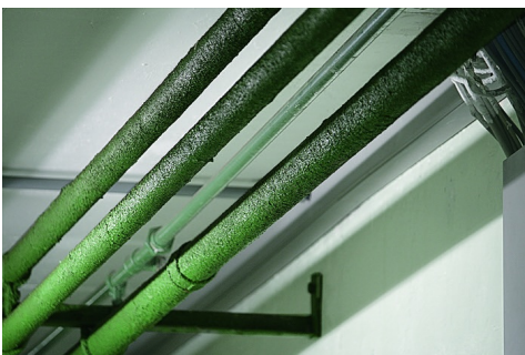
Asbesthaltige Farbe auf Leitungen, Suva
