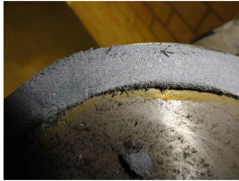
Detailaufnahme Litaflex an Heizrohr. Photo: Carbotech AG
