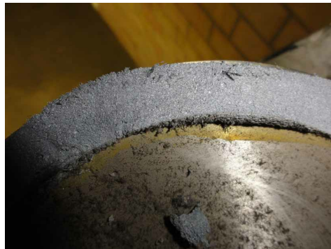
Detailaufnahme Litaflex an Heizrohr. Photo: Carbotech AG
