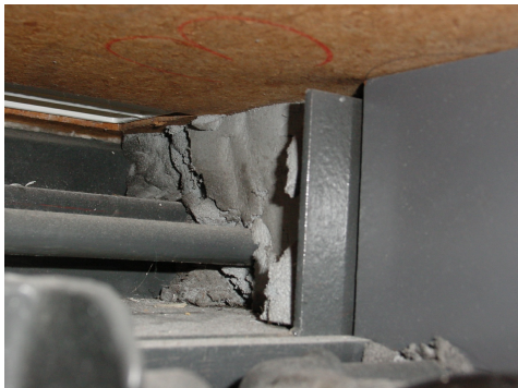
Litaflex als Brandabschottung bei Mauerdurchführung von Heizungsrohren im Brüstungsbereich. Photo: Carbotech AG
