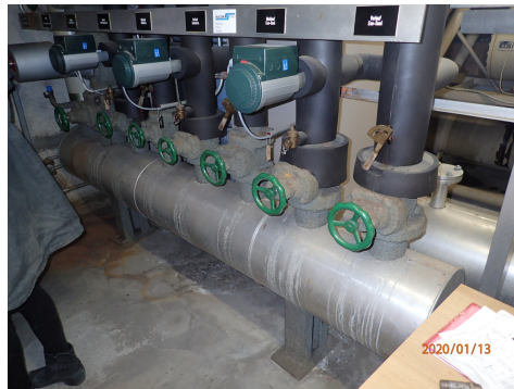
Transpirex mit Asbest (20-50 % Chrysotil) im Heizungsraum eines Schulhauses (Photo: Carlos Campoamor, Arcadis Schweiz AG)
