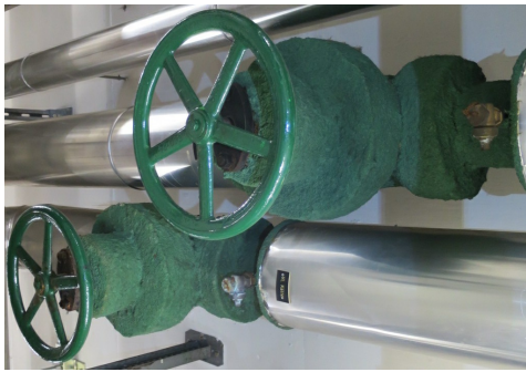
Transpirex mit Asbest (Photo: Gebäuediagnostik Siegwart AG)
