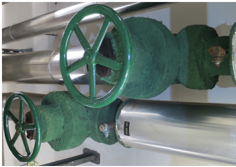
Transpirex mit Asbest (Photo: Gebäuediagnostik Siegwart AG)
