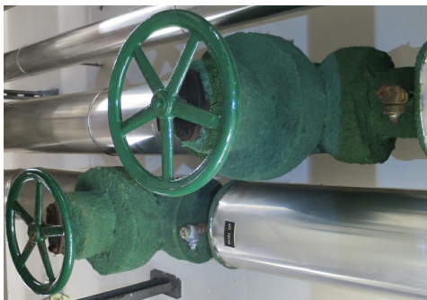
Transpirex mit Asbest (Photo: Gebäuediagnostik Siegwart AG)
