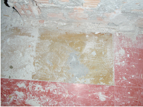
Kunststoff-Kleber unter Vinyl-Platten (hier ohne Asbest)
