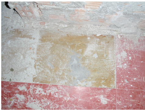
Kunststoff-Kleber unter Vinyl-Platten (hier ohne Asbest)
