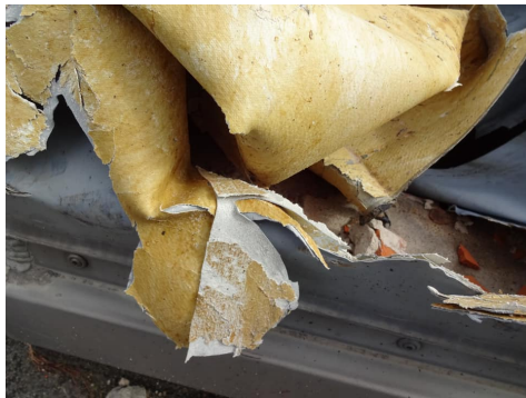
Detail der beschädigten Kamin-Abdeckung aus asbesthaltigem Hypalon. Photo: J. Meyer, Solgeo AG
