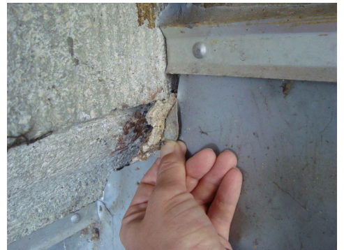
Hypalon mit Asbest. Beide Seiten. Photo Carbotech.
