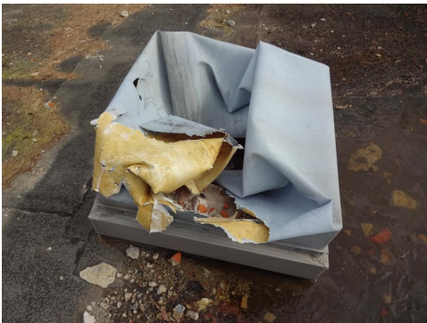
Beschädigte Kaminabdeckung aus Hypalon. Das Dach selber war ebenfalls mit Hypalon abgedeckt (unter der Bitumen-Pappe, die neueren Datums ist). Photo: J. Meyer, Solgeo AG
