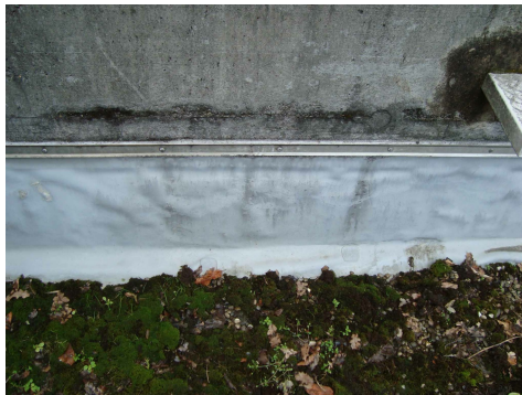
Hypalon mit Asbest. Oberseite. Photo Carbotech.
