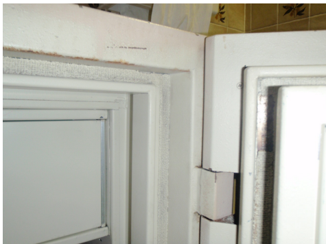
Tresor mit asbesthaltiger Dichtung in Türe
