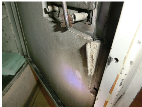
Asbesthaltige Leichtbauplatte LAP in Tresor. Diese lassen sich meist relativ einfach im offenen Zustand durch Abschrauben der inneren Blende kontrollieren. Ebenfalls können Proben mit einem spitzen Werkzeug aus den Tablarlöchern entnommen werden. Photo: Ecosens AG, Wallisellen.
