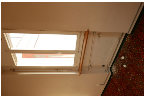
Spachtelmasse in einer Heizungsniische, SCS
