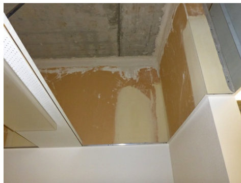
Spachtelmasse mit Asbest. Einbau in den 70er-Jahren. Photo Carbotech AG.
