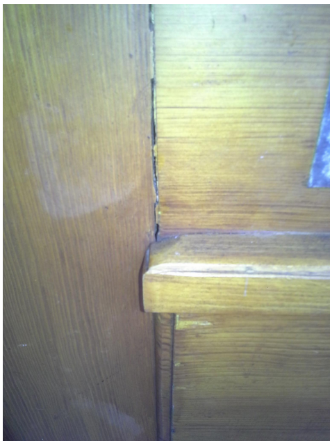
asbesthaltige Spachtelmasse auf Holz. Photo: Bafob GmbH
