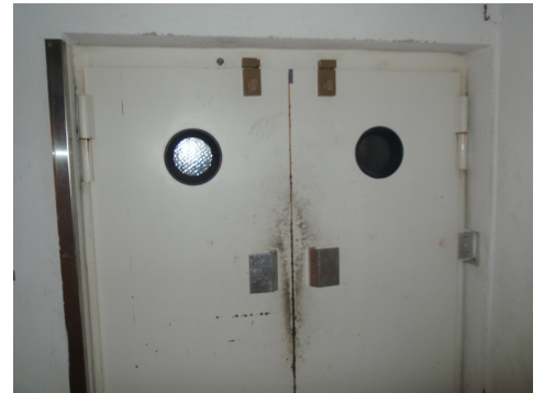
Lifttüren können eine Füllung mit Asbest enthalten.
