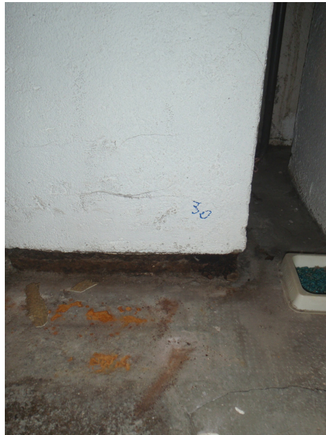
Asbestverdächtige Teerkork-Isolation unter Sockel von Liftmotor
