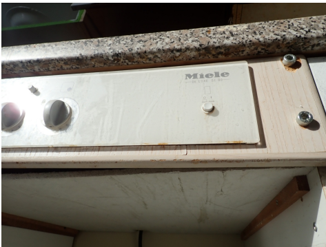
Asbesthaltige Leichtbauplatte unter Kochherd. Photo: S. Schneebeli
