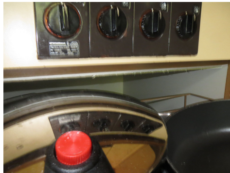
Leichtbauplatte mit Asbest unter Kochherd. Die Töpfe in der Schublade reiben über den Asbest. Photo Bafob GmbH.
