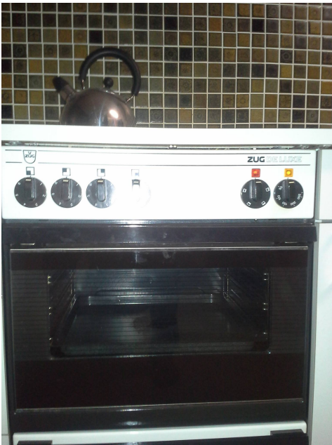
Photo Leichtbauplatte mit Asbest unter Herdplatte von Kochherd. Photo Bafob GmbH.
