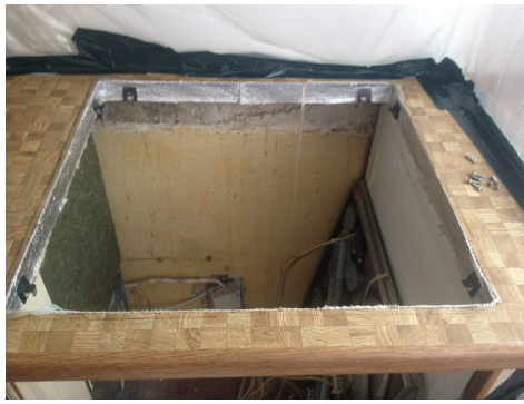
Asbestgewebe als Brand-/Hitzeschutz bei Kochherd, Photo Bafob GmbH.
