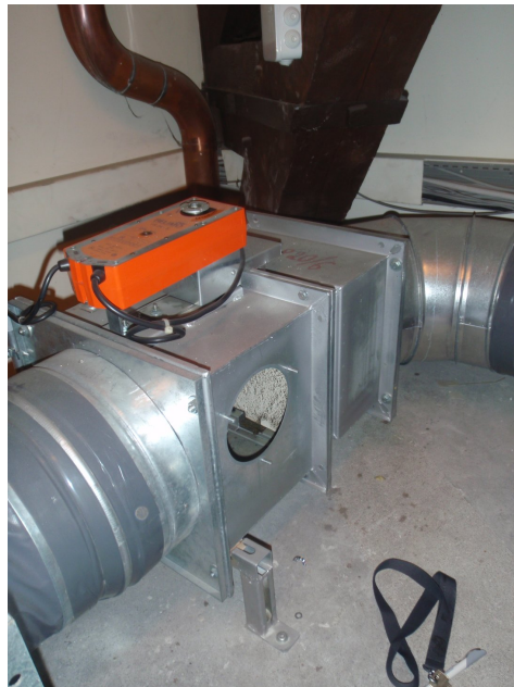
Brandschutzklappe in einer Neueren Lüftungsanlage (ohne Asbest).
