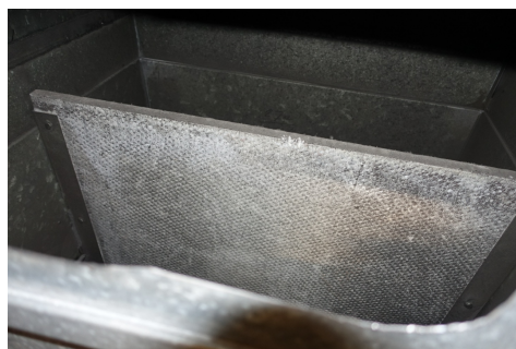
Brandschutzklappe mit Klappenblatt aus Asbestzement, Carbotech
