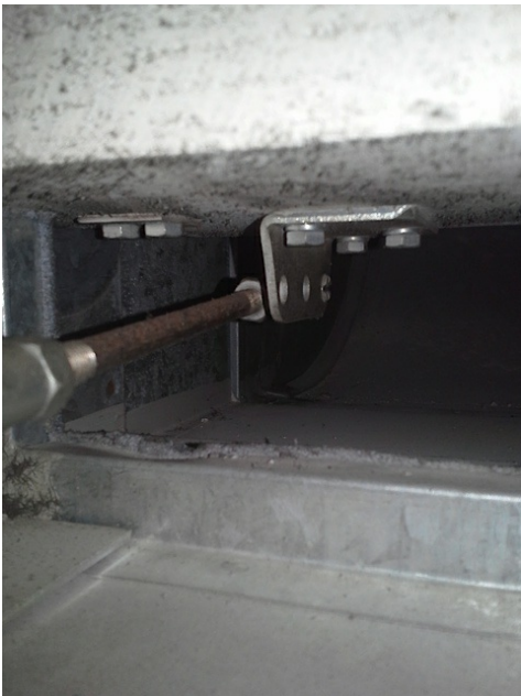
Brandschutzklappe mit asbesthaltiger Dichtung
