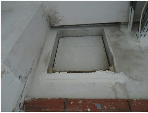
Leichtbauplatte auf Brandschutzklappe getackert, Arcadis Schweiz
