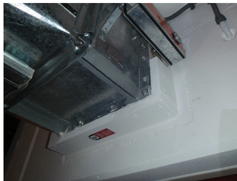
Asbesthaltigen Brandschutzplatten um das Belüftungsrohr
