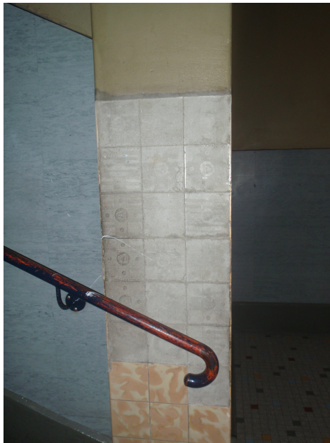
Wenn die Fliesen abgefallen sind, kann der Kleber, wenn er in schlechtem Zustand ist, eine gewisse Gefahr bei einer normalen Nutzung darstellen.
