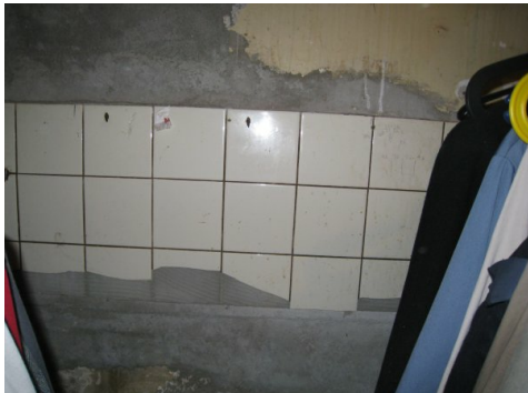
Fliesenkleber mit Asbest - Spuren der Zahnkelle im Kleber
