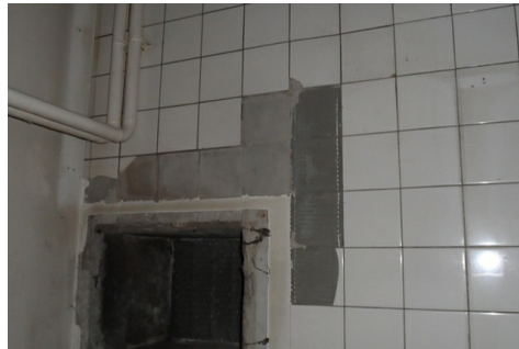
Fliesenkleber mit Asbest - hinter den gleichen Fliesen können sich verschiedene Kleber verbergen.
