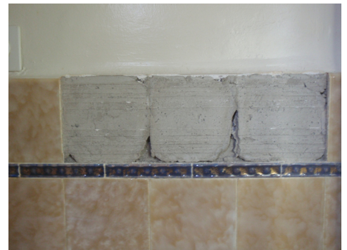
Mörtel unter Fliesen, der in "Batzen" aufgetragen wurde, enthält nach gegenwärtigem Wissensstand in der Regel KEIN Asbest und wird nur ausnahmsweise untersucht.
