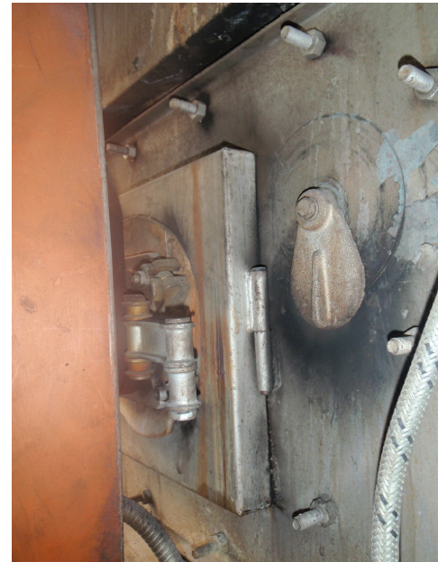
Dichtungen an Brennern können bereits in schlechtem Zustand sein und somit eine gewisse Gefährdung für die Gesundheit darstellen.
