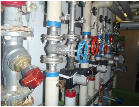
Alte IT-Dichtungen enthalten sehr oft Asbest.
