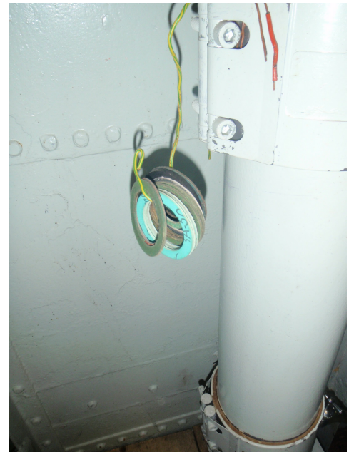
Vorrat an Dichtungen die Asbest enthalten können
