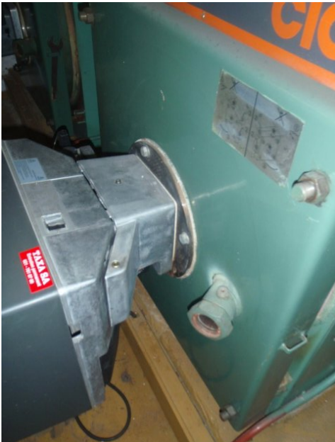
Dichtung am Brenner einer Heizung. Hier handelt es sich um ein schwachgebundenes Material.
