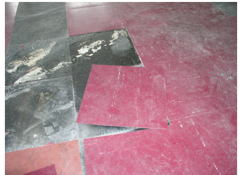
Rote Floorflexplatten mit bituminösem Kleber, Suva
