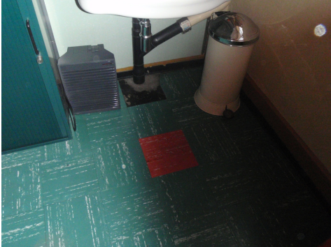
Vinyl-Bodenplatten mit Asbest
