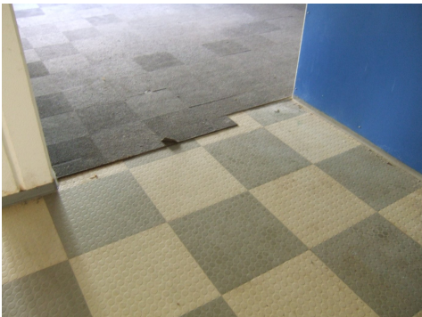
Vinyl-Platten mit Noppen (hier asbestfrei)
