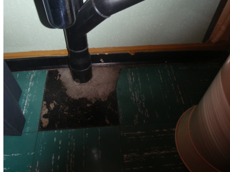
Vinyl-Bodenplatten. Drunter bituminöser Kleber - ebenfalls mit Asbest
