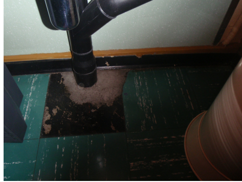
Vinyl-Bodenplatten. Drunter bituminöser Kleber - ebenfalls mit Asbest
