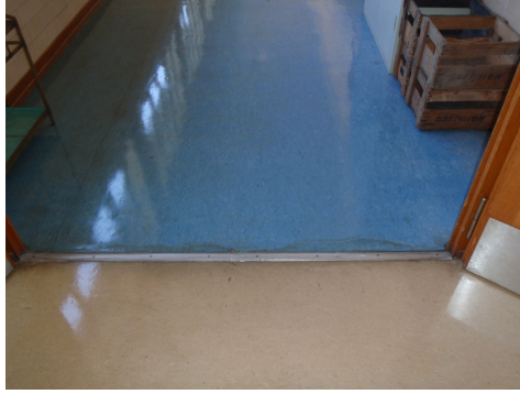
Bodenbelag vom Typ Linoleum
