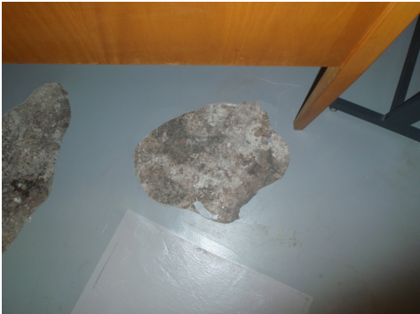
Kunstharz-Bodenbelag mit Asbest in der Haftschrift.
