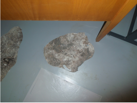
Kunstharz-Bodenbelag mit Asbest in der Haftschicht.
