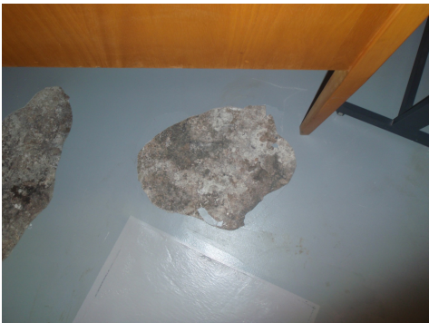
Kunstharz-Bodenbelag mit Asbest in der Haftschicht.
