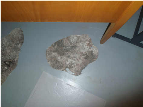
Kunstharz-Bodenbelag mit Asbest in der Haftschrift.
