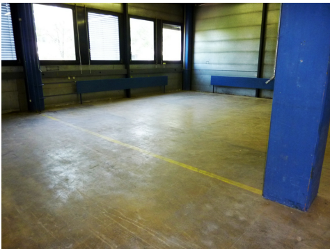
Holzzementboden mit Asbest. Photo: Arcadis AG, Simon Küng.
