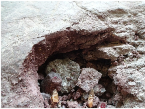
Holzzementboden mit Asbest
