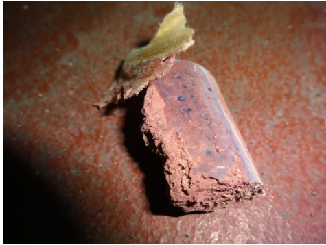
Holzzementboden mit Asbest
