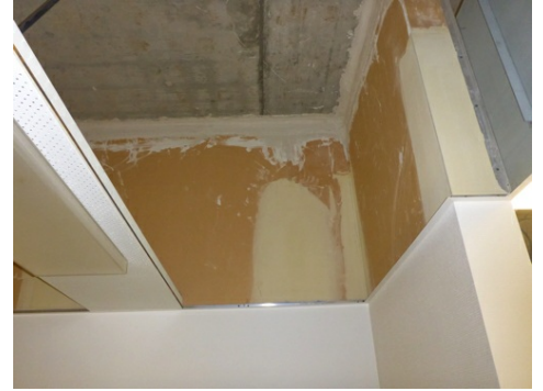
Spachtelmasse mit Asbest. Einbau in den 70er-Jahren. Photo Carbotech AG.
