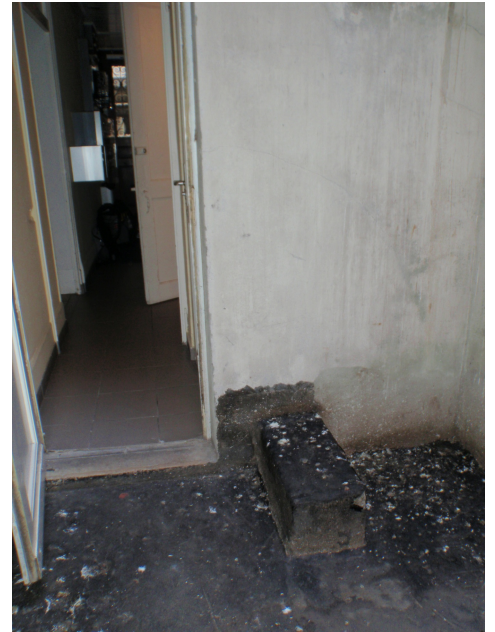
Bitumen-Dichtung mit Asbest in Innenhof
