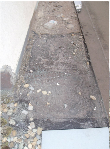
Bitumen-Abdichtung auf Dach. Hier enthielt nicht die Dachpappe Asbest, sondern nur der Kleber.
