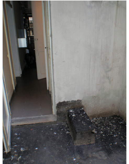
Bitumen-Dichtung mit Asbest in Innenhof
