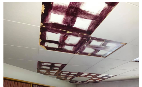
Deckenplatten mit asbesthaltigem Kleber, Solgeo
