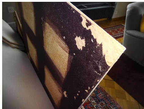
Deckenplatten mit asbesthaltigem Kleber, Solgeo
