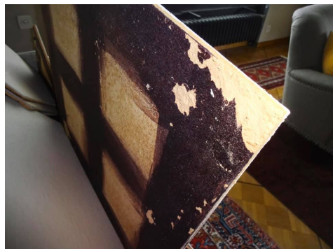
Deckenplatten mit asbesthaltigem Kleber, Solgeo
