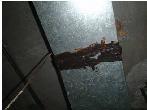
Fuge von Lüftung die mit asbesthaltigem Kleber (Bitumen?) abgedichtet ist.
