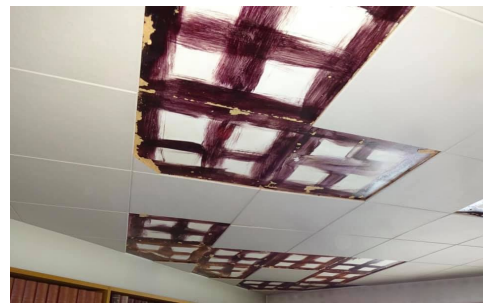
Deckenplatten mit asbesthaltigem Kleber, Solgeo
