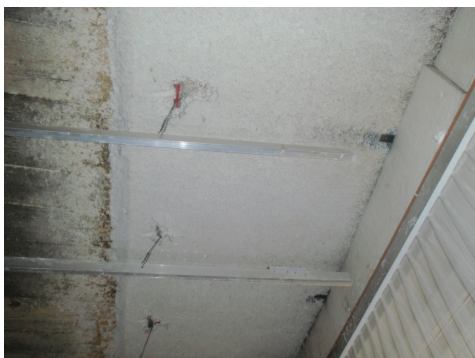
Spritzasbest als Wärmeisolation an Betondecke
