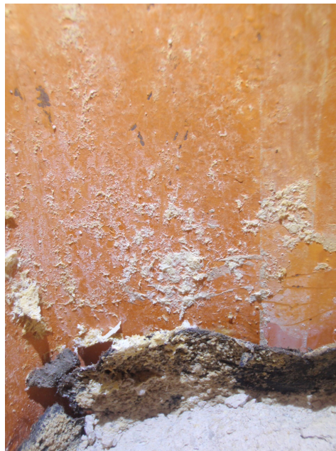
Ungenügend gereinigter Stahlträger.
