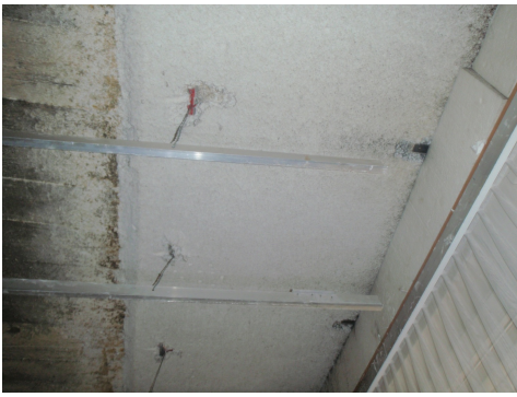
Spritzasbest als Wärmeisolation an Betondecke
