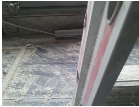
Am Boden verteilter Spritzasbest während Sanierung. Solche Verunreinigungen sind während der Sanierung nicht zulässig. Ausserdem muss das Material während der Sanierung benetzt sein.
