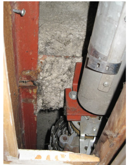
Spritzasbest in Rollladenkasten. Photo SC+P Sieber Cassina + Partner AG
