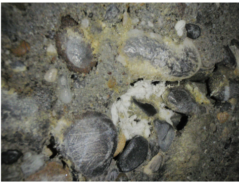
Reste von Spritzasbest nach Sanierung (weiss). Poröser Beton kann praktisch nicht 100% sauber saniert werden.
