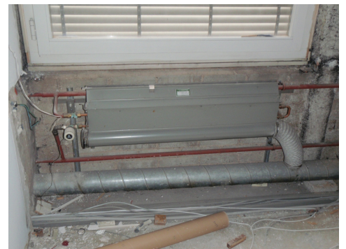
Spritzasbest als Wärmeisolation auf Stahlträger (rechts von Heizung/Lüftung)
