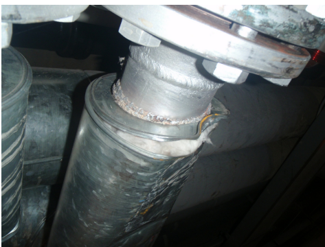
Asbestgewebe auf Rohr.
