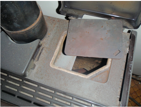
Asbest-Band in Ölofen
