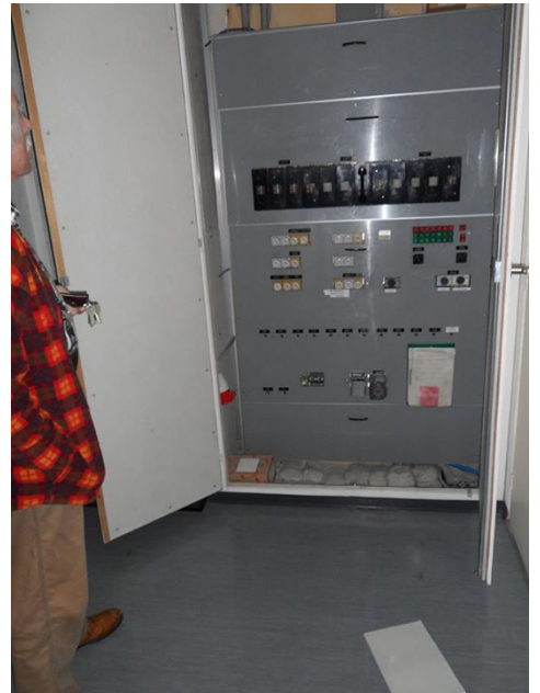
Asbest-Kissen (bei Kabel-Durchführungen und LAP (innenseite Türen) in Elektro-Schrank
