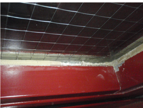
Brandschutztüre mit Asbestgewebe unter Fensterkitt
