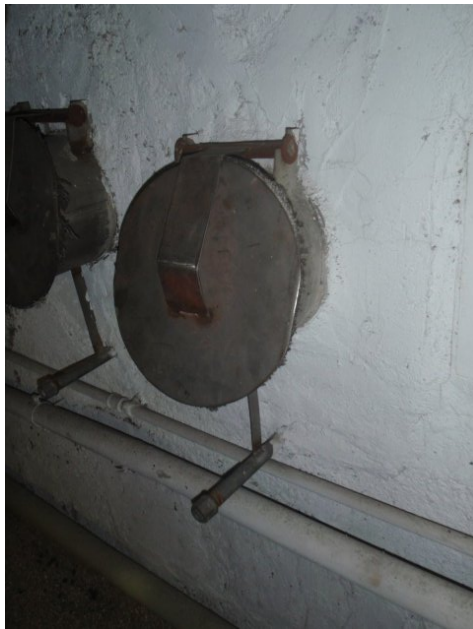
Klappen Kamin mit Asbest-Gewebe
