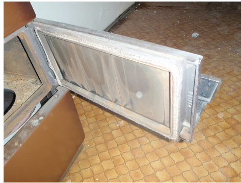
Asbest-Band in Ölofen
