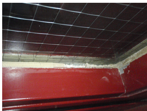
Brandschutztüre mit Asbestschnur unter Fensterkitt
