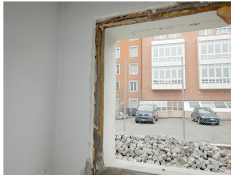
Anschlagkitt ist manchmal tief zwischen Zarge (Fensterrahmen) und Mauer eingefügt. Am besten von aussen her durch das Aufschlagen des Fassadenmörtels einsehbar. Photo A. Pfister, Jäckli AG
