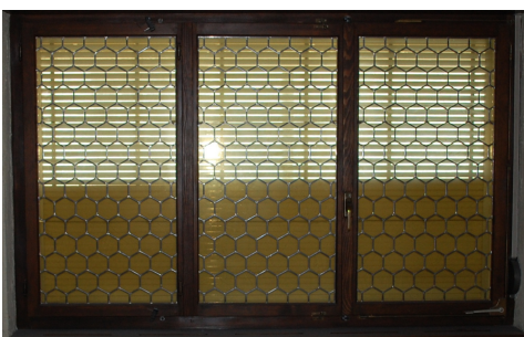
Bleiverglaste Fenster mit Asbest im Kitt. Die Kunstglaser rührten den Kitt entweder selber an, dann enthält dieser kein Asbest oder sie verwendeten Fertigprodukte, die sie mit Leinöl
