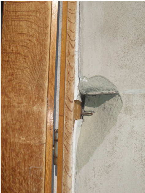
Anschlagkitt mit Asbest (zwischen Fensterrahmen und Mauerwerk)
