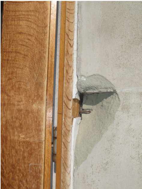
Anschlagkitt mit Asbest (zwischen Fensterrahmen und Mauerwerk)
