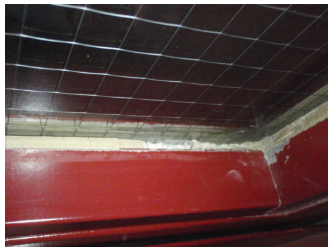
Brandschutztüre mit Asbestschnur unter Fensterkitt
